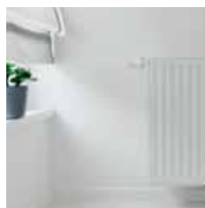
Riscaldamento con radiatori a bassa temperatura
